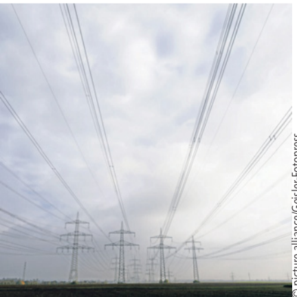
Überlandleitungen verteilen den Strom in der Bundesrepublik.
