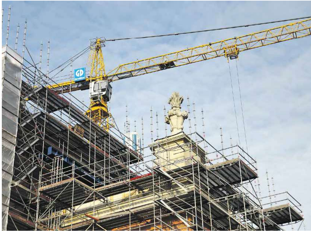
Baustelle für den Wiederaufbau des Turms der Garnisonkirche im Dezember 2020 Foto: imago
